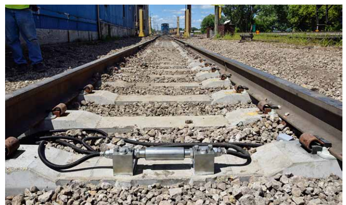
Abb. 4: Sensoren auf der Schwellenmitte
